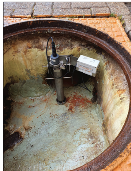
Obr. 2. Příklad z praxe: IoT hub DataFly s bezdrátovým výstupem na hladinoměru měřícím výšku hladiny ve vrtu
